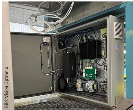
Die installierte Steuerungseinheit für das Faltenerkennungssystem.
